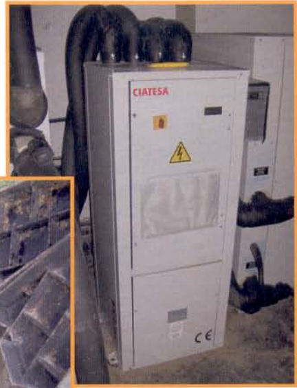
Foto 4. Bomba de calor
