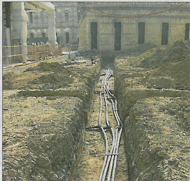
Las tuberías actúan como colectores de calor/frío. LEVANTE-EMV
