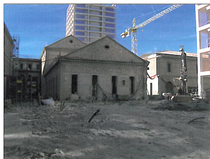
Disposición de las sondas geotérmicas y perforadora utilizadas en la climatización mediante geotermia en el complejo.
